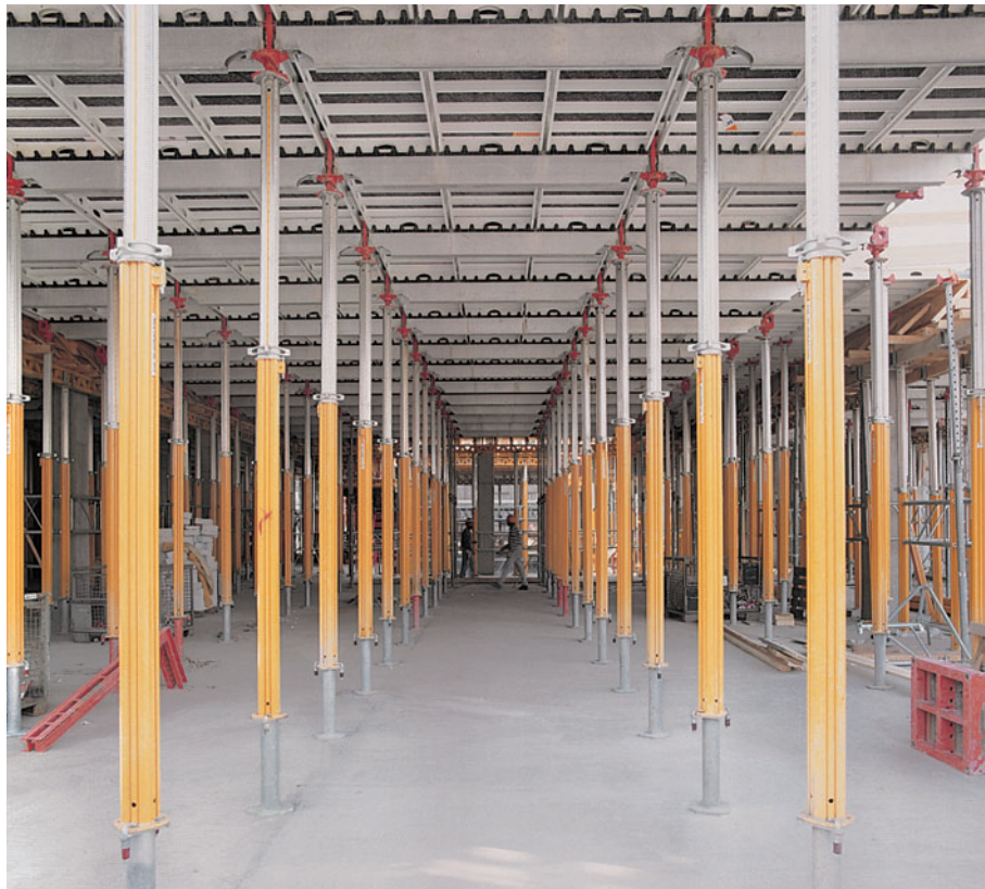
MULTIPROP 350 con la base MP 50 in abbinamento alla cassaforma SKYDECK per la realizzazione di un solaio con un'altezza netta di 4,10 m.
