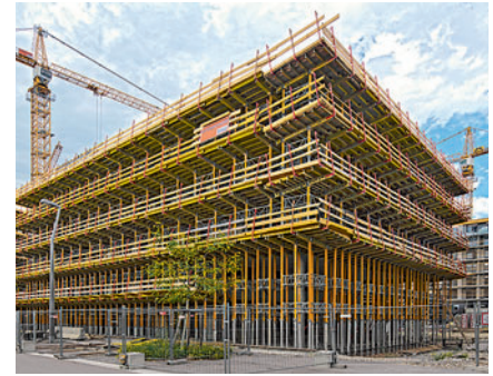
Die PERI Lösung mit MULTIPROP und MULTIFLEX und zum Schalen der umlaufenden Balkone war gleichzeitig auch Arbeitsgerüst.
