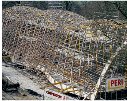
MULTIPROP Stützen trugen die Holzkonstruktion und brachten die Gitterschale in eine gekrümmte Form.
