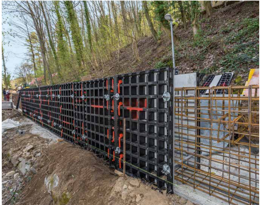
Die 120 m lange und 1,20 m hohe Stützwand wurde mit der DUO von Hand ohne maschinelle Unterstützung geschalt.
