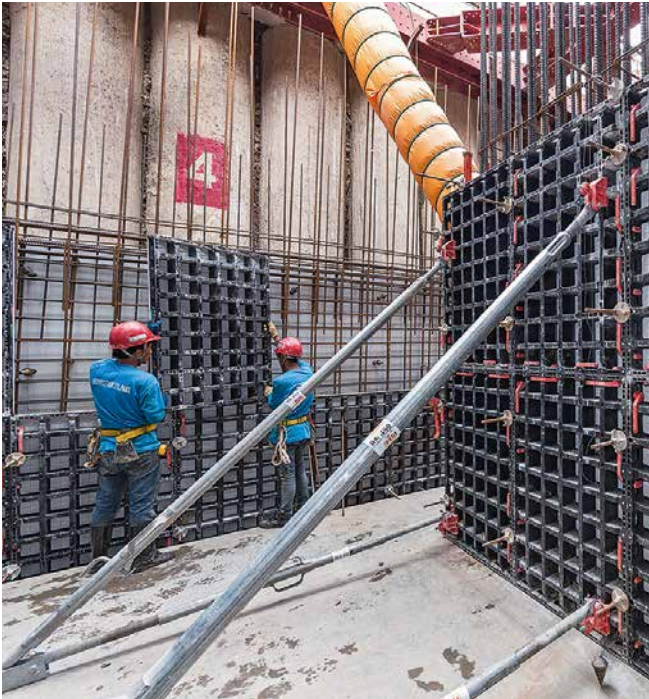
Geringes Gewicht, kleinformatische Schalungselemente – diese Vorteile spielt DUO bei diesen Tiefgeschosswänden voll aus.
