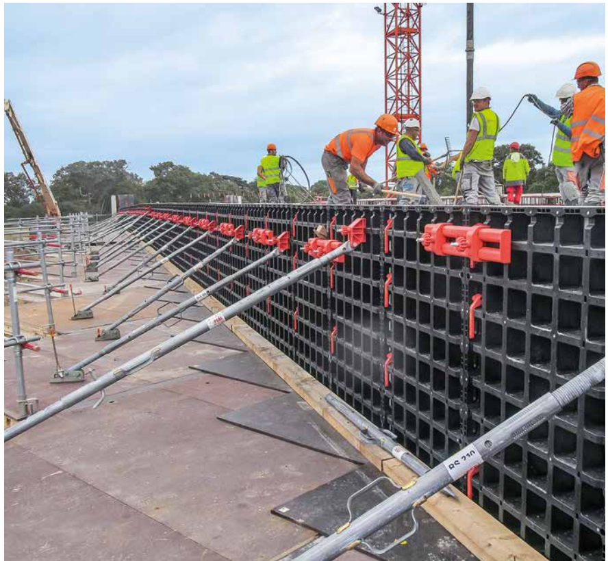
DUO ist mit kleinen Paneelgrößen und einfachem Handling prädestiniert zum Schalen von Fundamenten.
