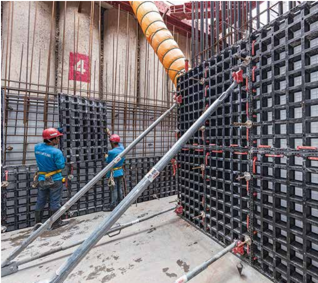
Geringes Gewicht, kleinformatierte Schalungselemente – diese Vorteile spielt DUO bei diesen Tiefgeschosswänden voll aus.
