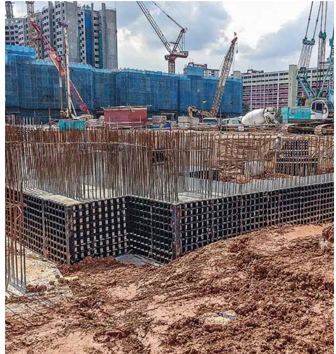
Die DUO Paneele eigneten sich bestens für das Schalen von kleinformatigen Betonbauteilen mit geringen Oberflächenanforderungen.
