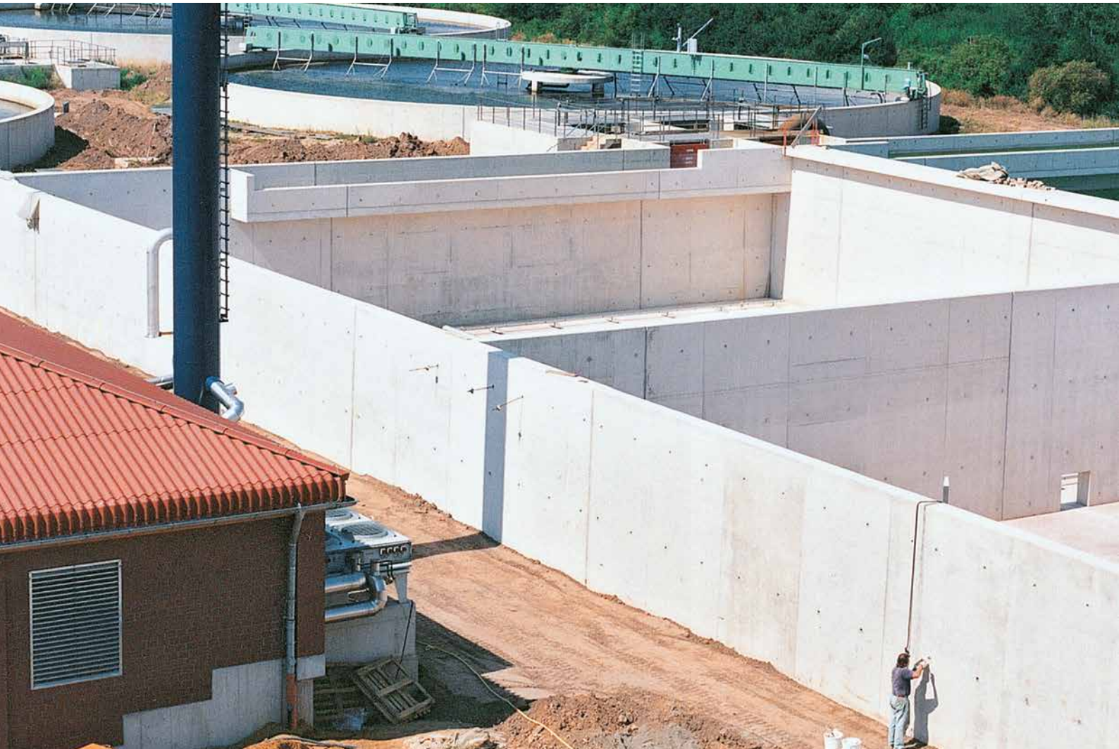
Kläranlage in Hameln, Deutschland.
