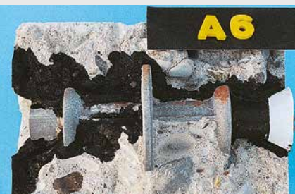
Schwindrissbildung gefährdet die Wasserundurchlässigkeit bei Wasserstoppmittelteilen ...
