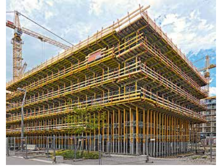
La solution PERI, constituée des systèmes MULTIPROP et MULTIFLEX, était destinée au coffrage des balcons ; elle servait parallèlement de console de travail.
